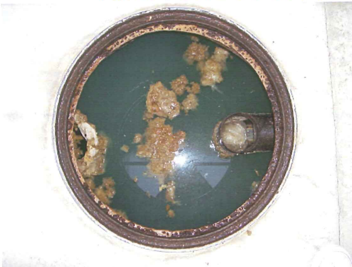
1槽目(汲み取る槽)
