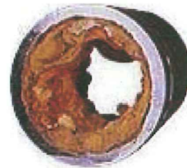
【築25年のマンションの配管】
